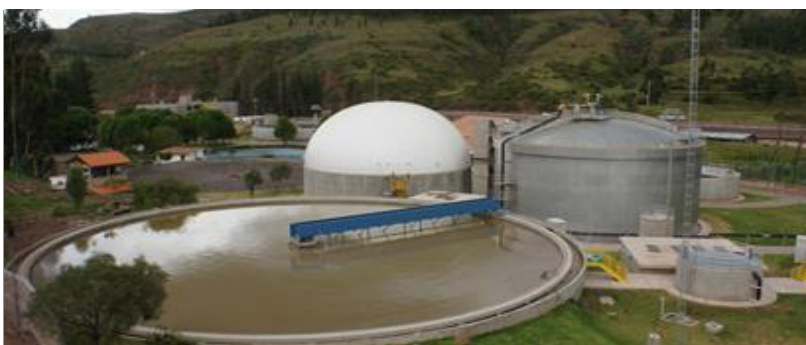
Biogasanlage in der Kläranlage Cusco.
